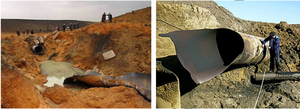
Рисунок 1.5 - Наслідки аварії на газопроводі, спричинені витоками газу
