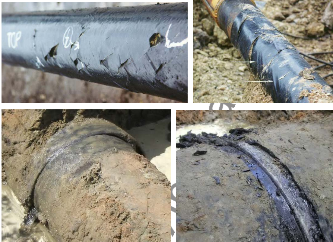
Рисунок 4.5 - Приклади пошкодження ізоляційного покриття трубопроводів
