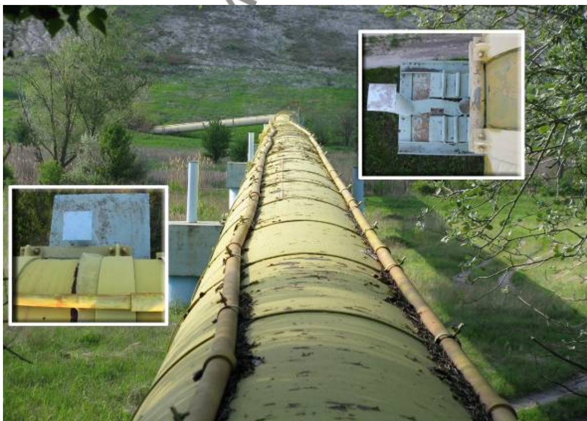
Рисунок 3.2 - Фрагмент повітряного переходу магістрального газопроводу «Союз» через р. Айдар
