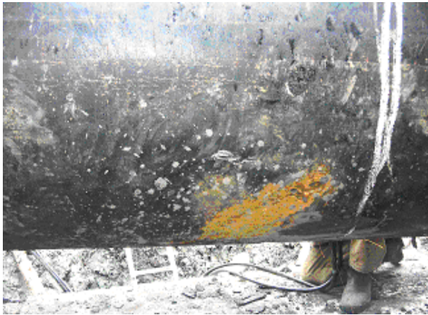
Рисунок 1 – Експлуатаційний дефект на зовнішньому боці труби
