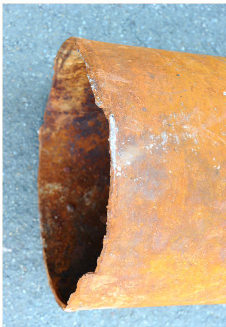
Рисунок 1 – Вид зруйнованого зварного шва
