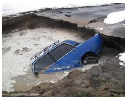
Рисунок 2 – Провали ґрунту в результаті підповерхневих витоків з підземних теплових мереж безканальної прокладки
