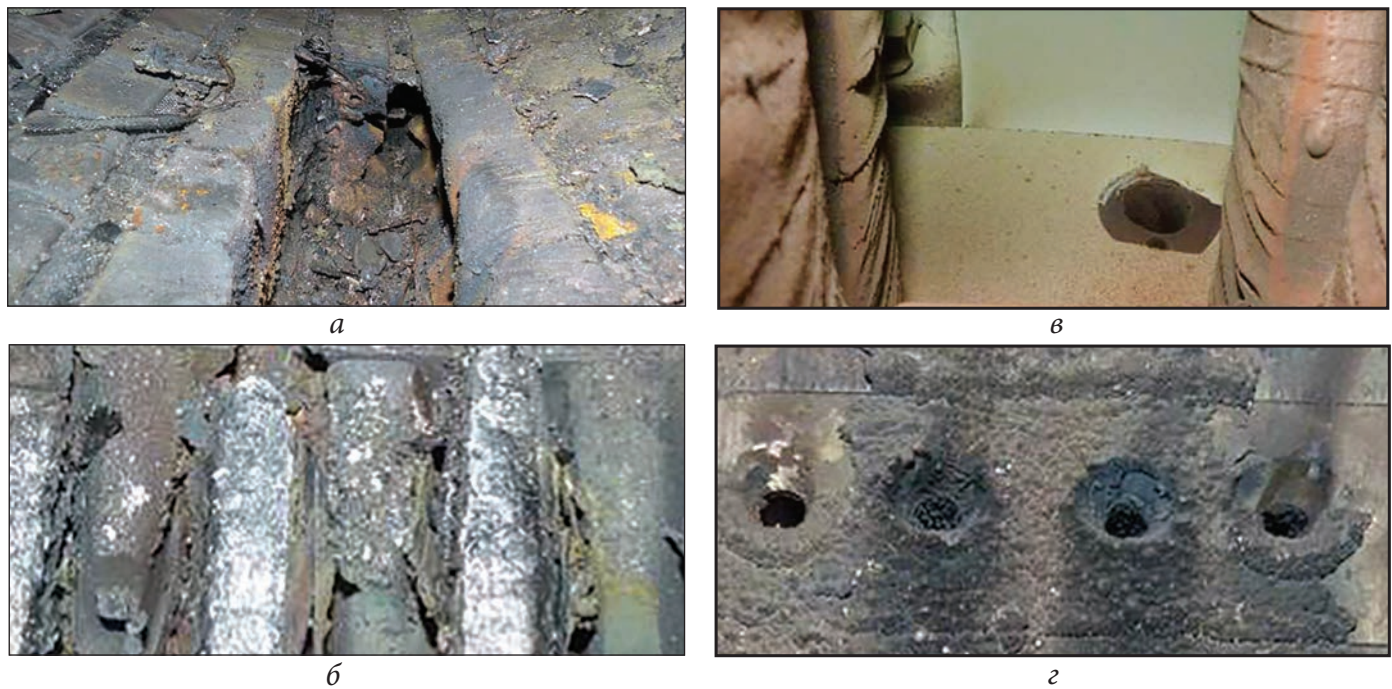
Рис. 3. Зафіксовані пошкодження: а та б – пошкодження паза статора електродвигуна; в – відсутність болта кріплення статора; г – пошкодження елементів ротора
