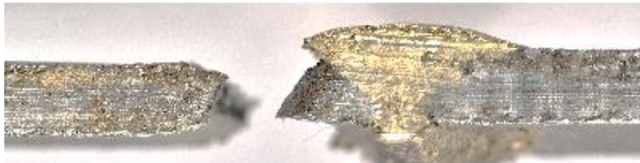
Рисунок 6 – Зруйноване з'єднання труб
