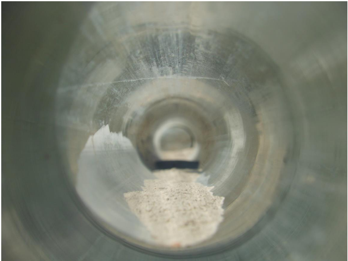
Рисунок 3.7 – Наявність сухого бариту в трубопроводі
