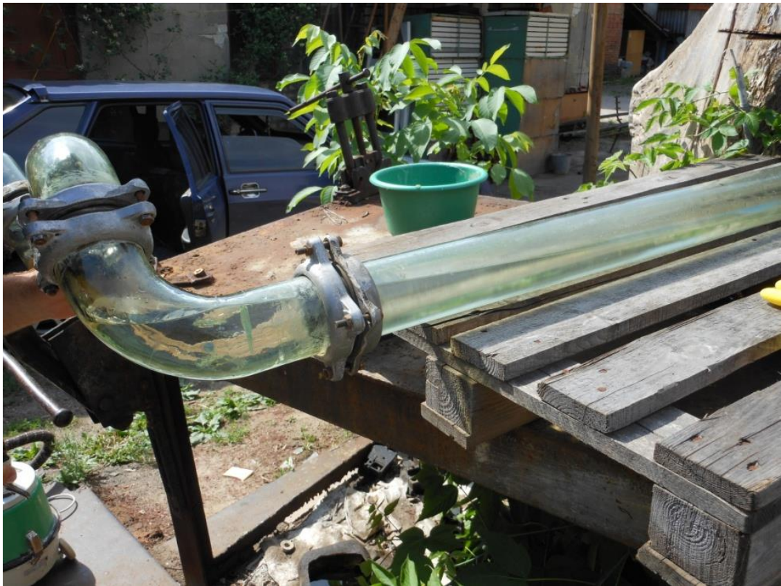
Рисунок 3.4– Вода в порожнині трубопроводу
