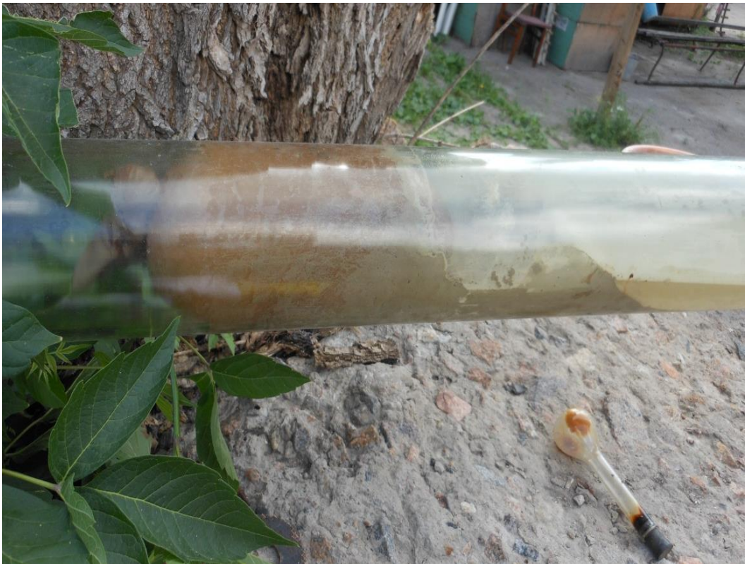
Рисунок 3.8 – Пробка в порожнині трубопроводу
